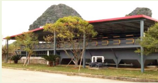
提升改造后的污水处理站
